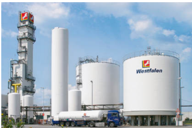
L'installation moderne de séparation des gaz de l'air à Hörstel, Allemagne.
