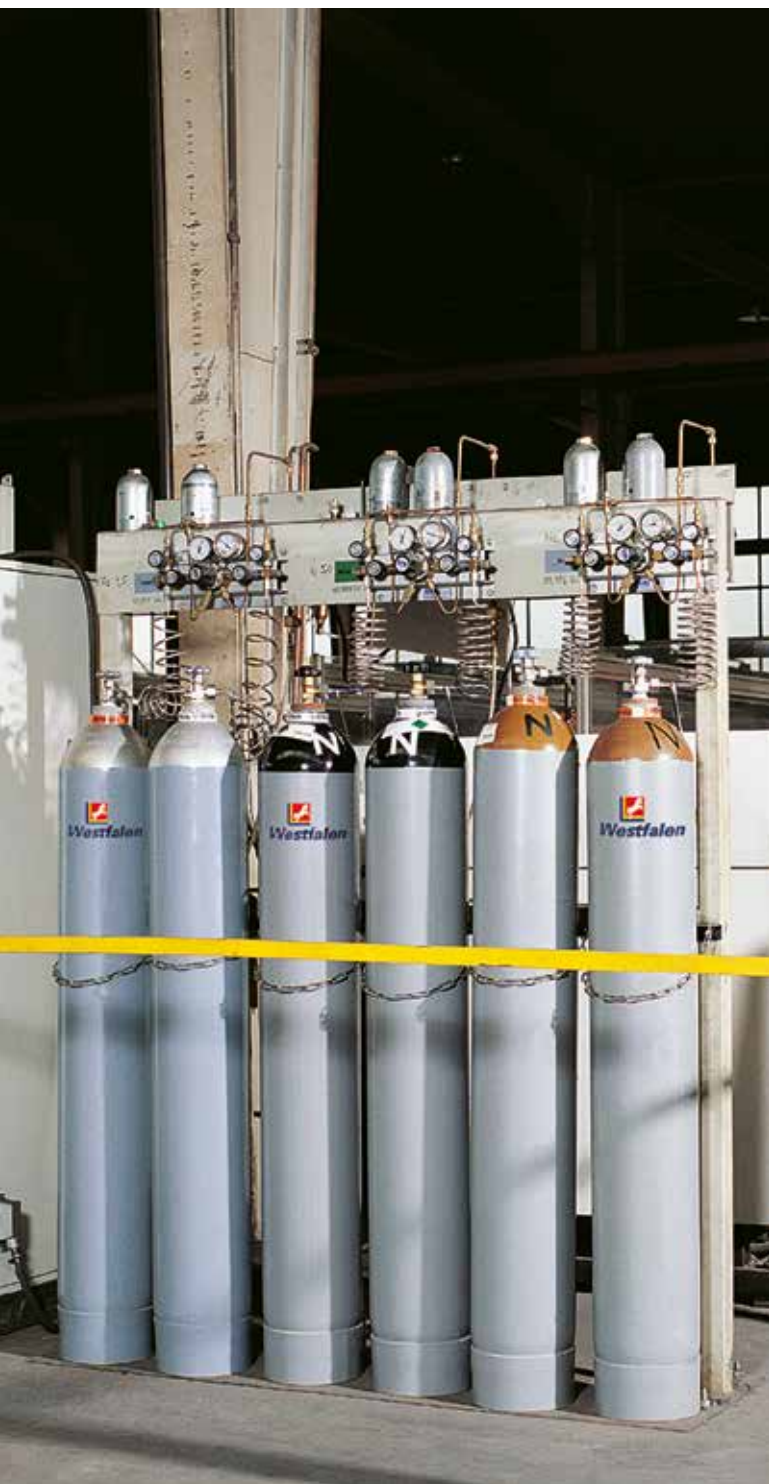
Betriebsgas-Versorgung mit Kohlendioxid 4.5, Stickstoff 5.0 und Helium 4.6.
