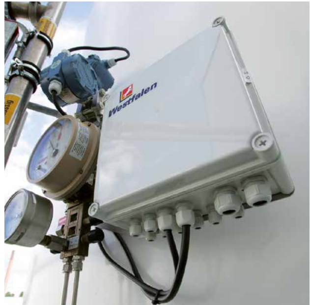
Komfortabel: Die automatische Füllstandsüberwachung mit dem Datafer®-System von Westfalen.
