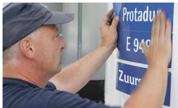
Vrijgave en kenmerking van een tankinstallatie voor Protadur®.
