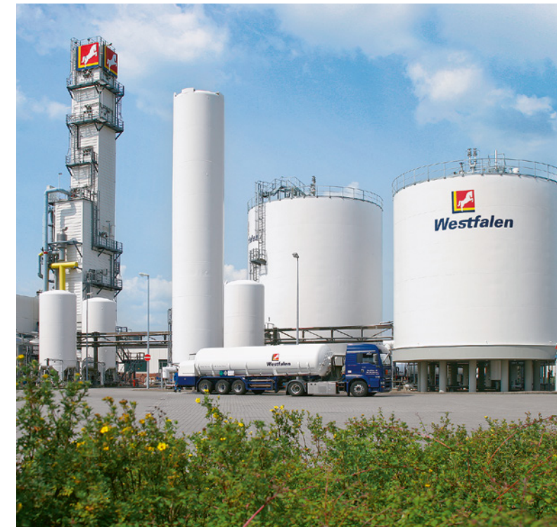
Moderne Luftzerlegungsanlage in Hörstel, Kreis Steinfurt.
